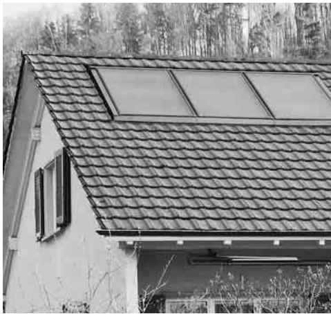
Die Standard-Solaranlage für die Familie – bald auf jedem Hausdach?
