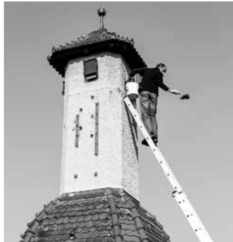
Reinigung des Falkenkastens am ausgedienten Turm einer Trafostation. Jedes Jahr werden dort 1–3 Junge grossgezogen.
